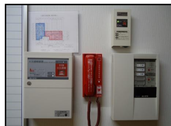
火災通報装置（異常を検知すると自動的に消防署に通報されます。）
