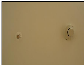
スプリンクラー、煙感知器 全館に設置しています。
